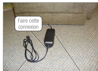
Cordon électrique de 120 volts Transformateur électrique
