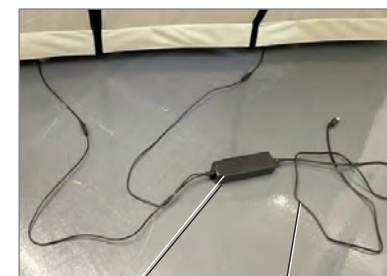
Transformateur électrique Cordon électrique de 120 volts
