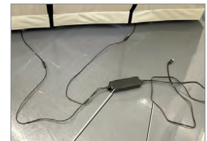
Transformateur électrique Cordon électrique de 120 volts
